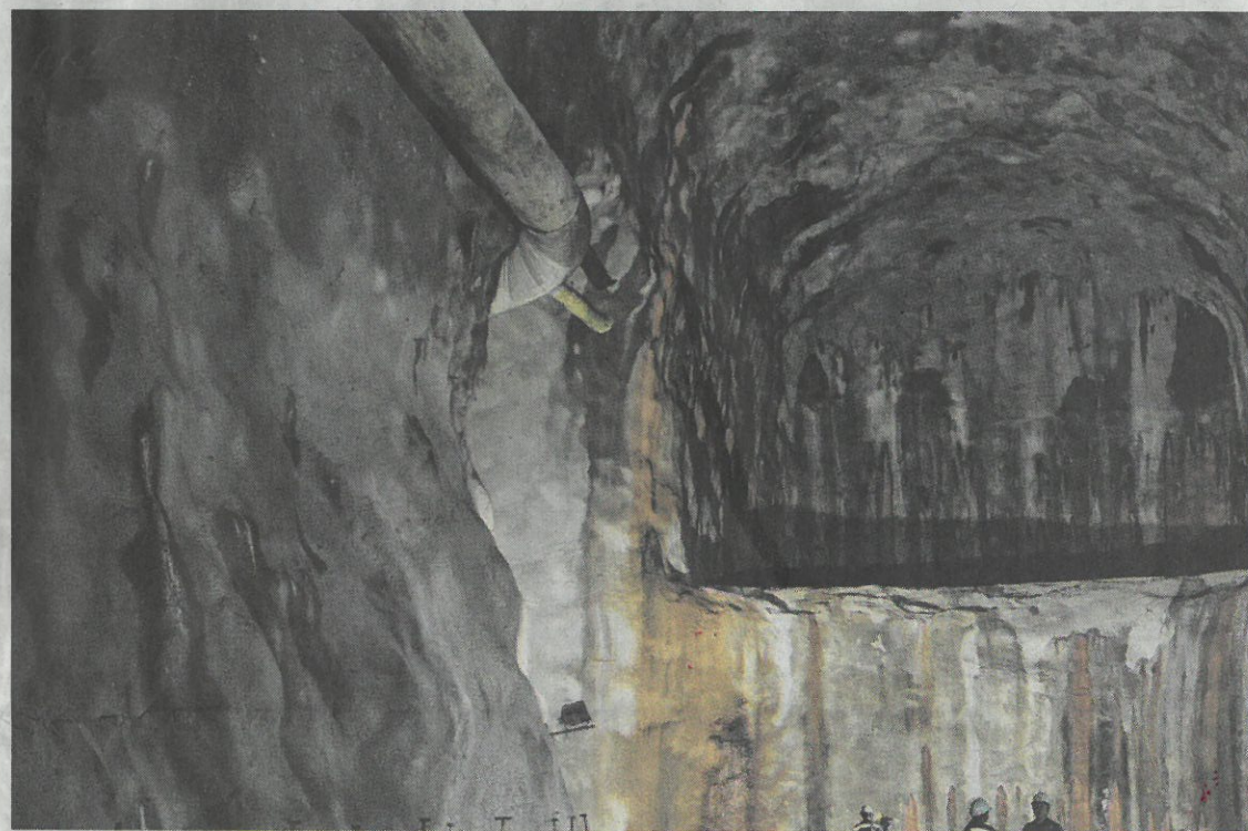
Le réservoir d'eau Jurong Rock Caverns, construit à 130 m de profondeur, à Singapour, en septembre 2014. BRYAN VAN DER BEEK/BLOOMBERG VIA GETTY IMAGES
